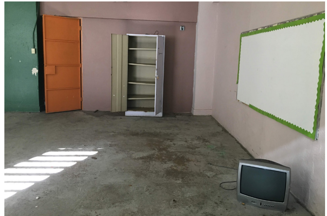
Salón de la escuela Dr. Martin Grove Brumbaugh en San Juan. El edificio permanece abandonado aunque la estructura está en óptimas condiciones. Al momento de la foto, se planteaba la posibilidad de reabrir escuelas cerradas para poder reubicar a los estudiantes afectados por los temblores de enero del 2020.
