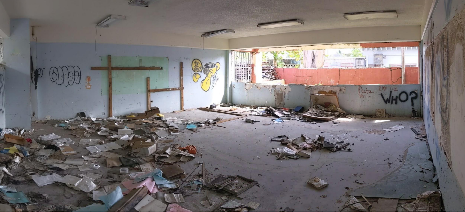
Escuela María Libertad Gómez en Toa Baja cerrada en 2016. Según la escala utilizada para propósitos de este estudio los planteles vandalizados y sin ventanas que, sin embargo, no muestran grietas en las paredes, filtraciones de techo o problemas estructurales se encuentran en buenas condiciones.
